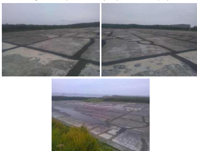
Figure 124 : Fissures réparées sur la dalle de l'impluvium (source : DCI Environnement, 2019)
